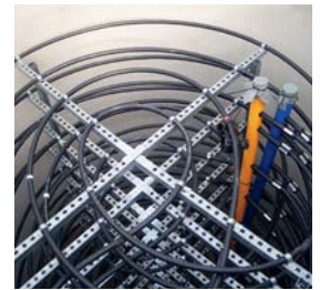
Entzugswärmetauscher im Eisspeicher
